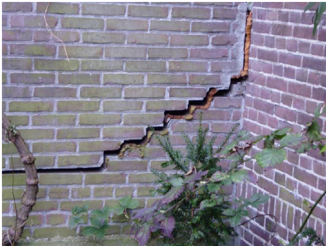
Fig. 3: Ernstige scheurvorming in het gevelmetselwerk als gevolg van funderingsproblemen.
